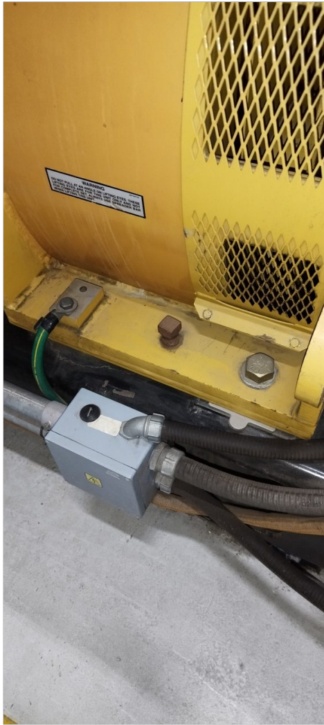
Anclajes de generador
