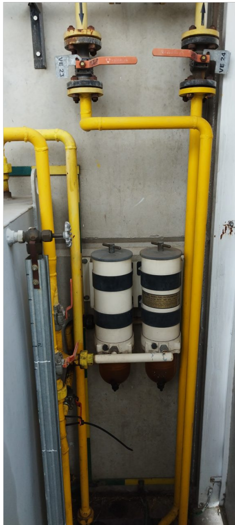
Cañerías de combustible y filtros trampa de agua
