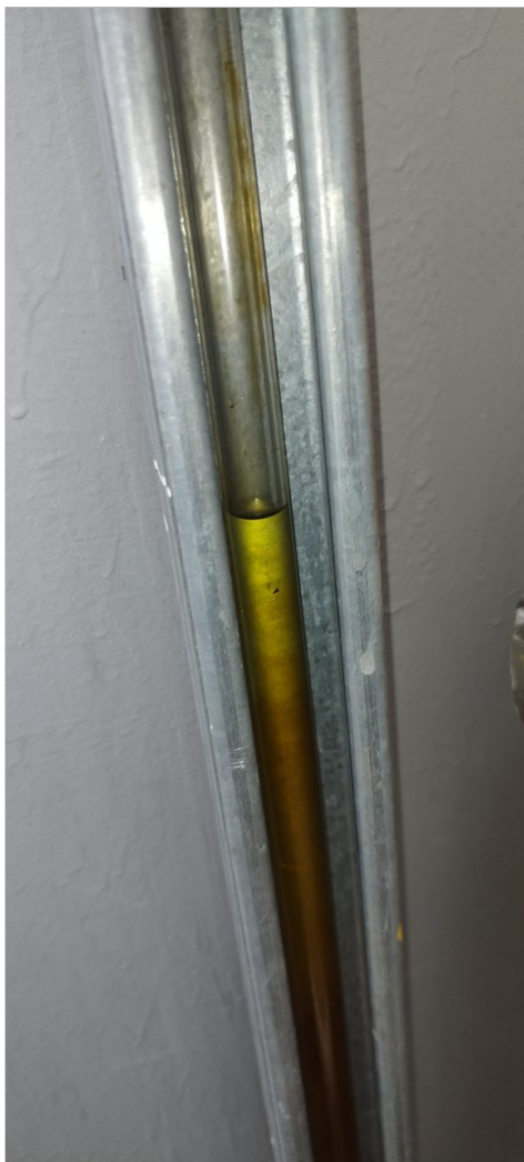
Nivel de tanque diario de combustible
