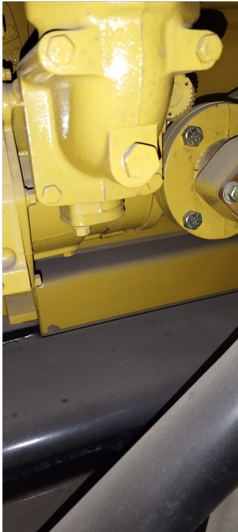
Bomba de agua de aftercooler
