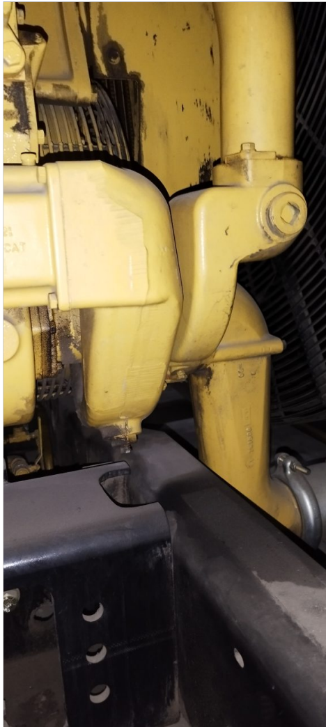
Bomba de agua de camisas
