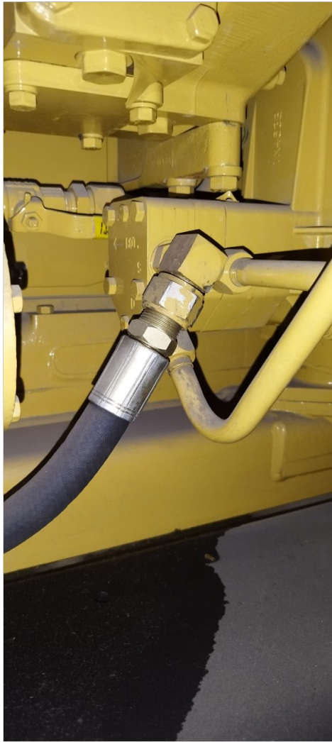
Bomba de transferencia de combustible y conexiones
