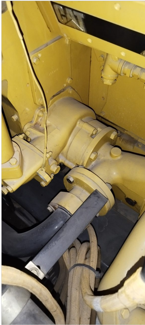
Bomba de agua de aftercooler
