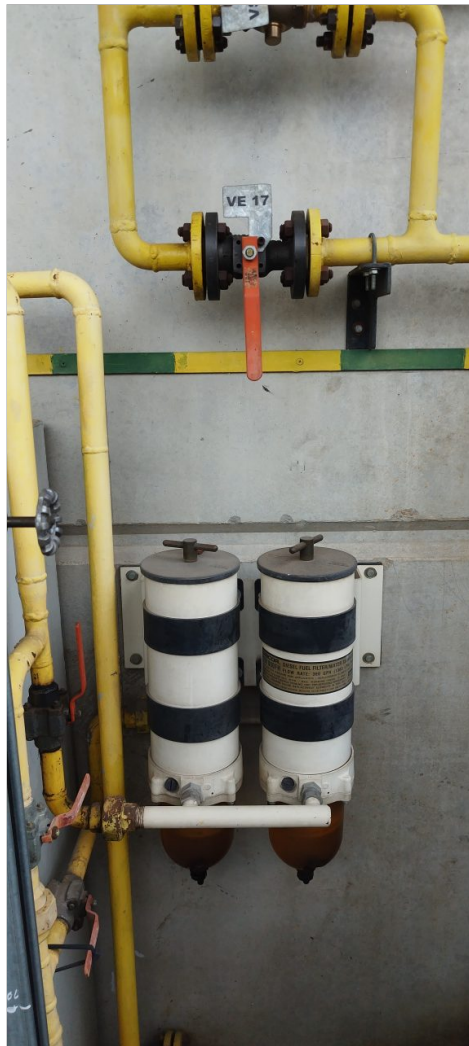
Lineas de combustible y trampa de agua
