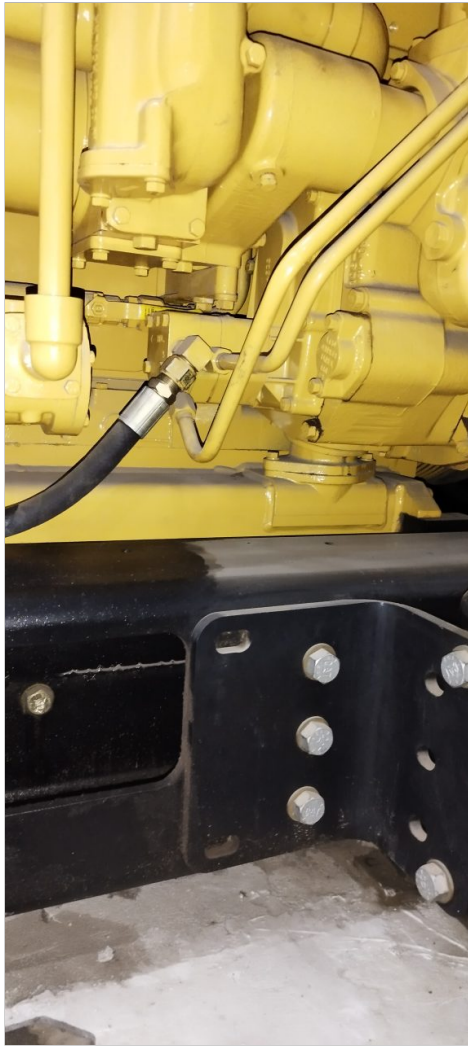
Bomba de transferencia de combustible y conexiones
