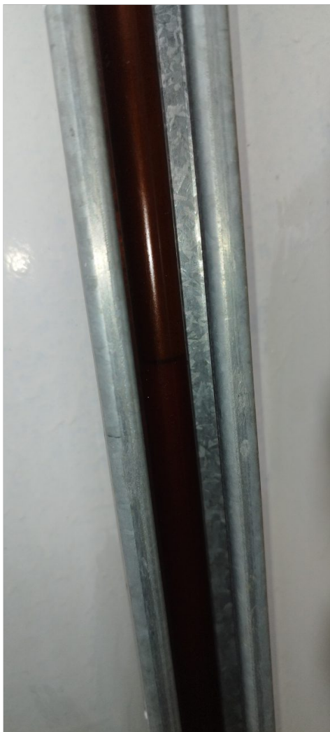
Nivel de tanque diario. Poca visibilidad
