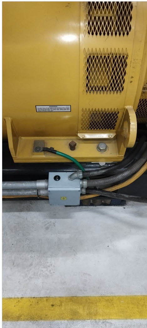
Anclajes de generador
