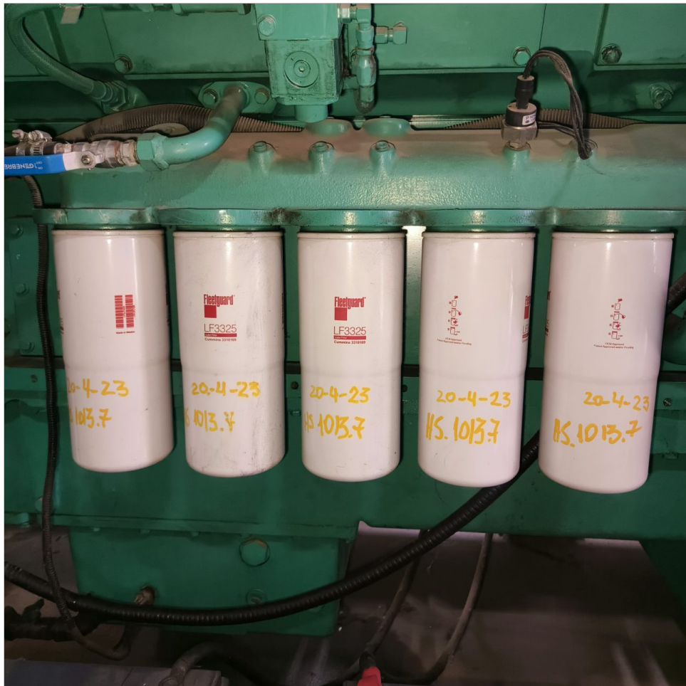
estado filtros de aceite
