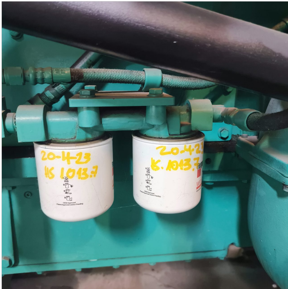
estado filtros de agua
