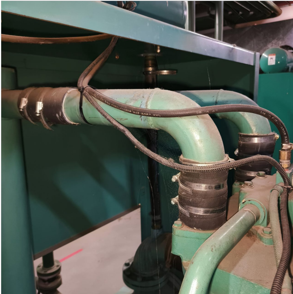
tuberías de agua
