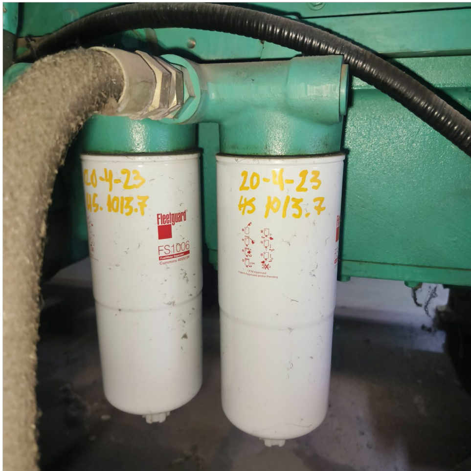
estado filtros de combustible
