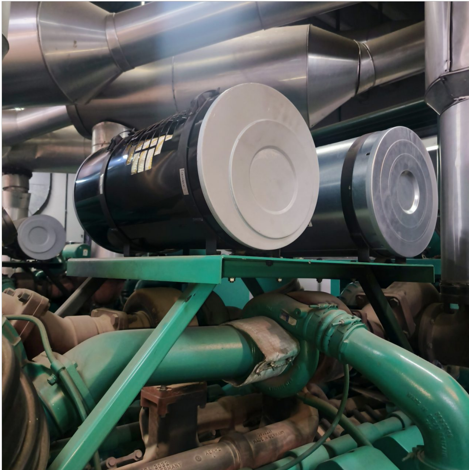
Sistema de aire y filtros
