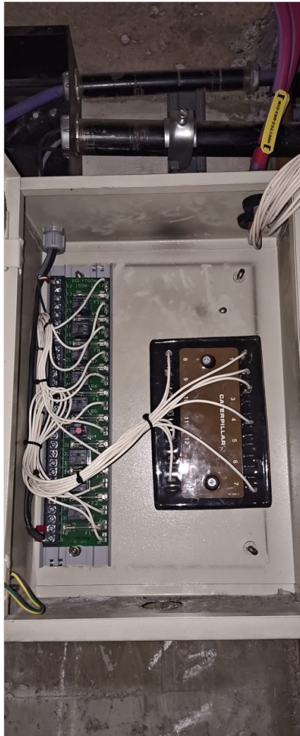
Módulo colocado dentro del gabinete
