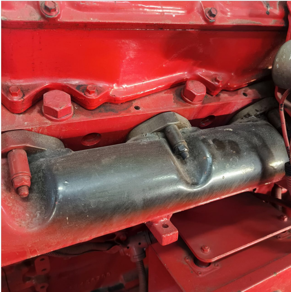
Deteccion de indicio de fuga gases de escape (foto 1)
