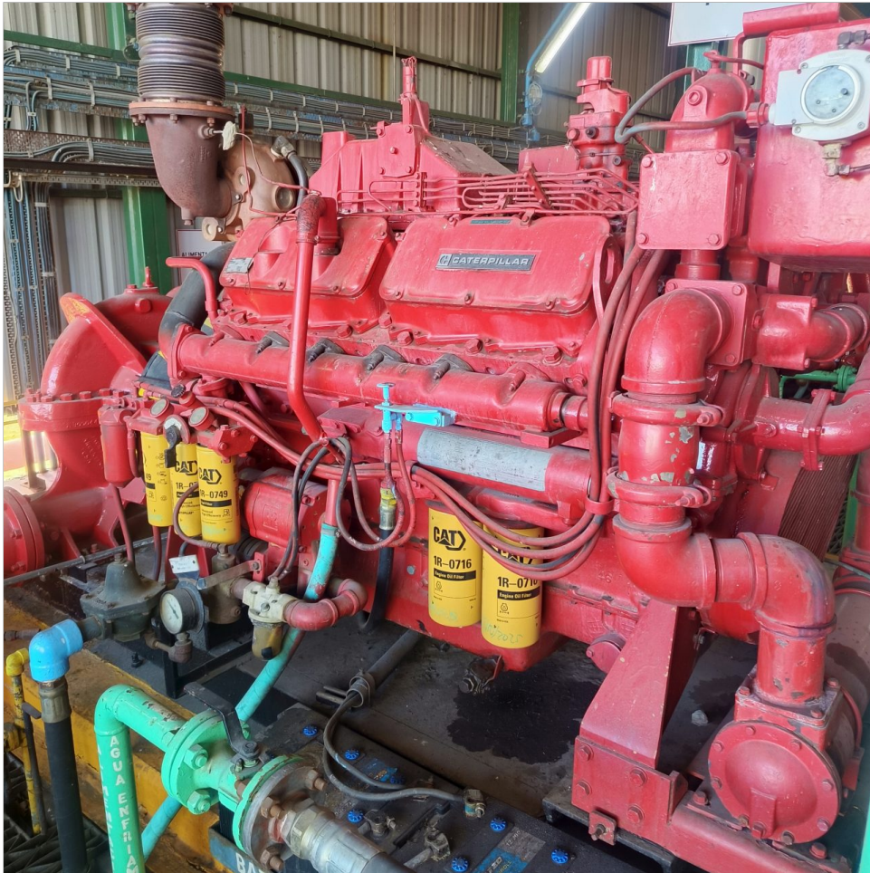
Revision de circuitos lado filtros
