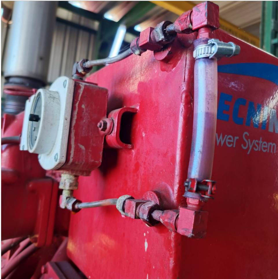
Deteccion de goteo en visor de nivel
