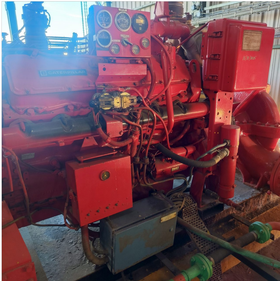
Revision de circuitos lado arranque
