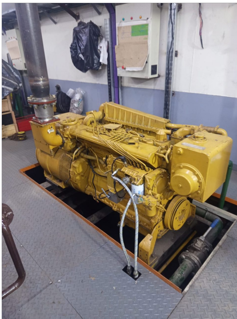
Generador 2 CAT 3306B
