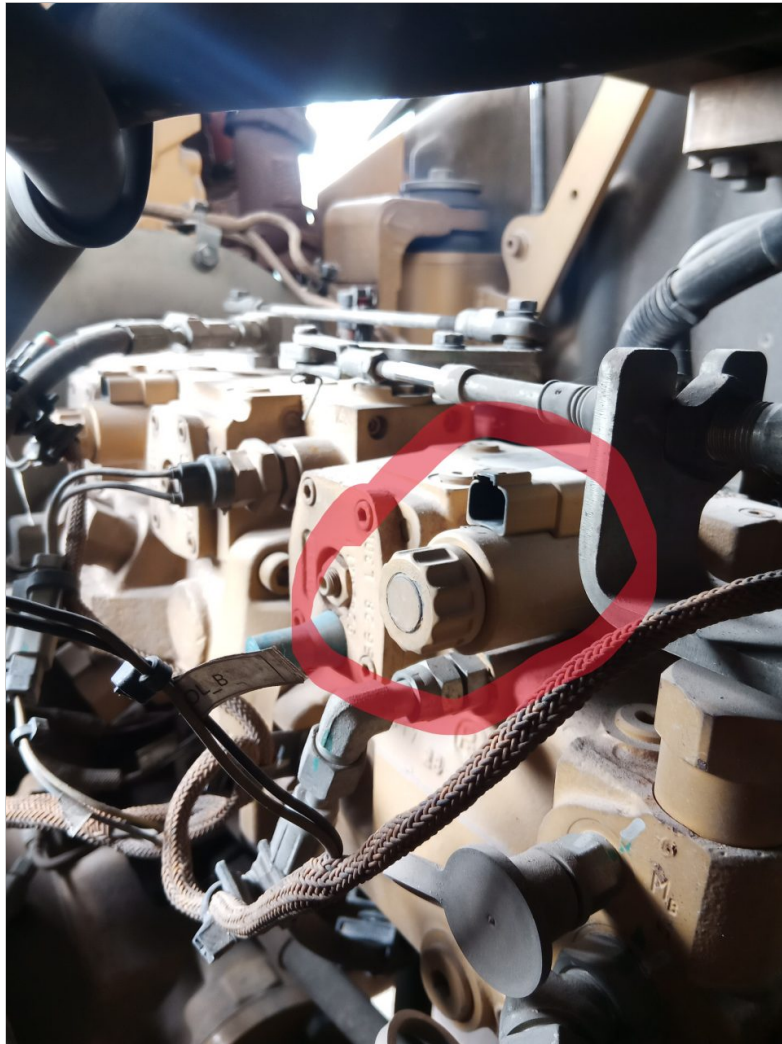
SOLENOIDE CON FALLA
