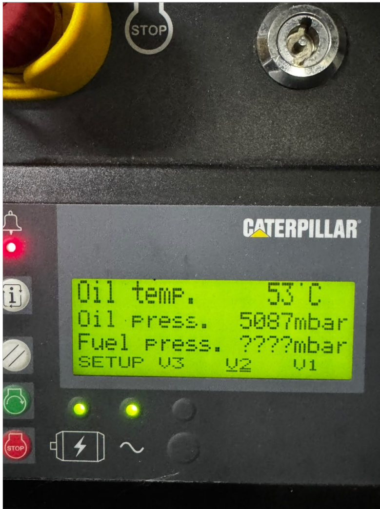
Presión de combustible
