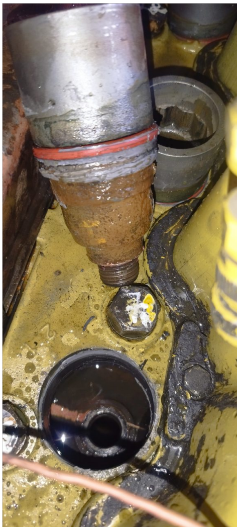
Presencia de pegamento
