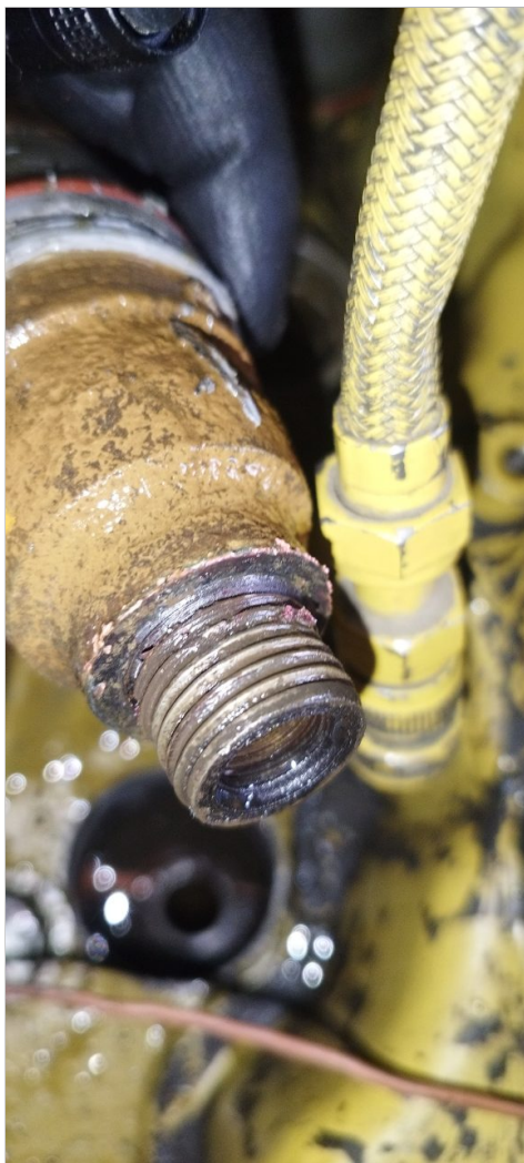
Estado de precamaras al momento de desmontarlas
