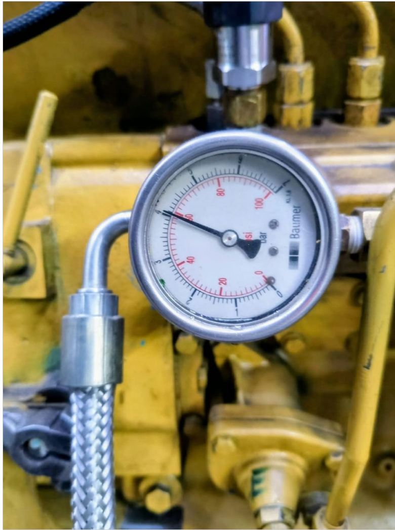
Manometro instalado en bomba inyectora en uno de los auxiliares, mostrando la presión nominal a la cual trabaja.
