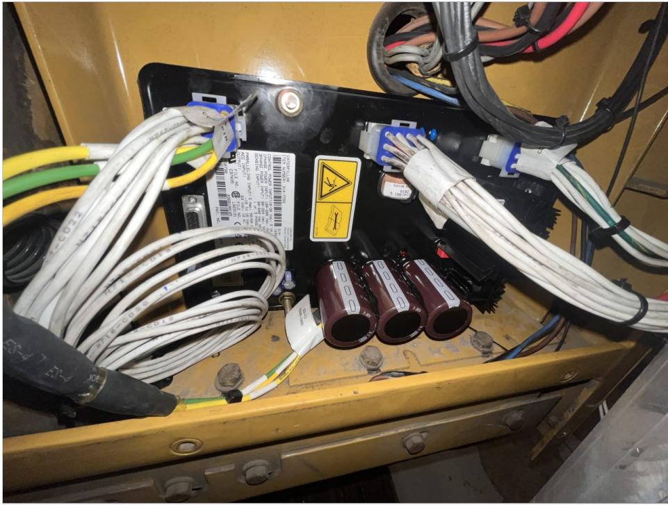
Módulo regulador cdvr nuevo instalado
