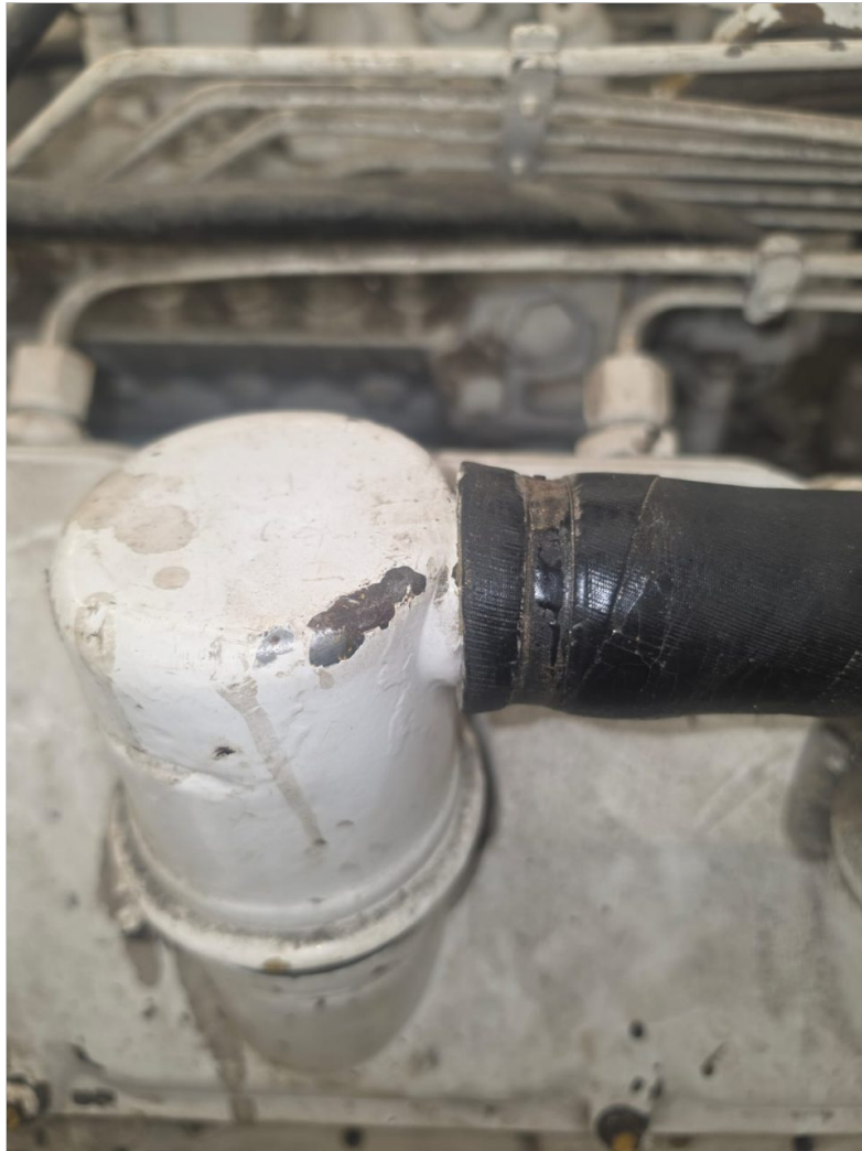
Faltantes de abrazaderas y mangueras en mal estado
