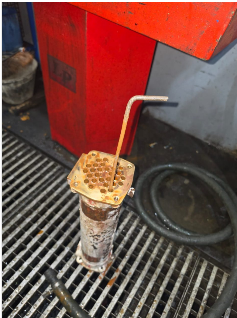
Limpieza de enfriador de transmision en taller
