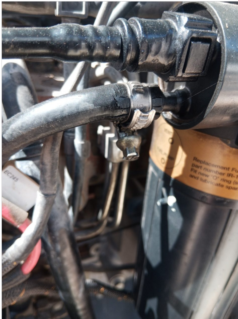
manguera dañada de combustible
