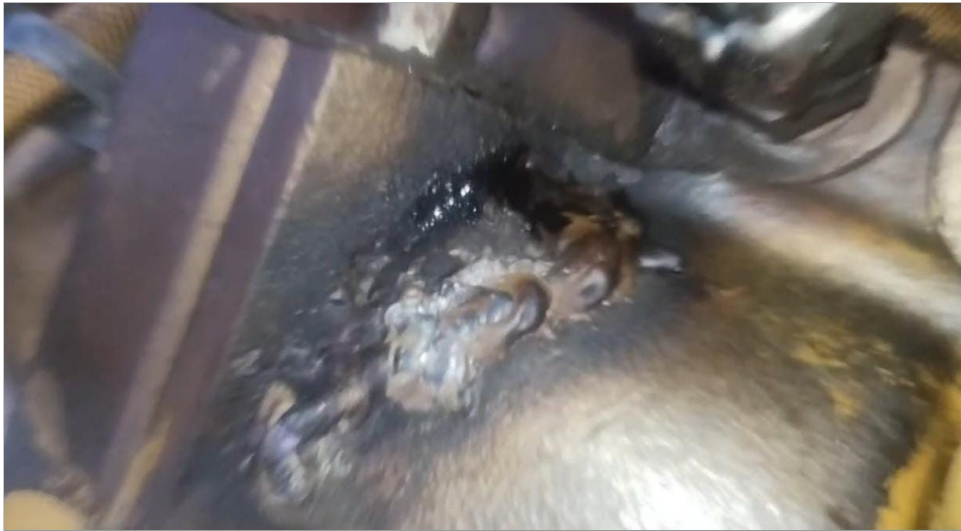
antes de reparar
