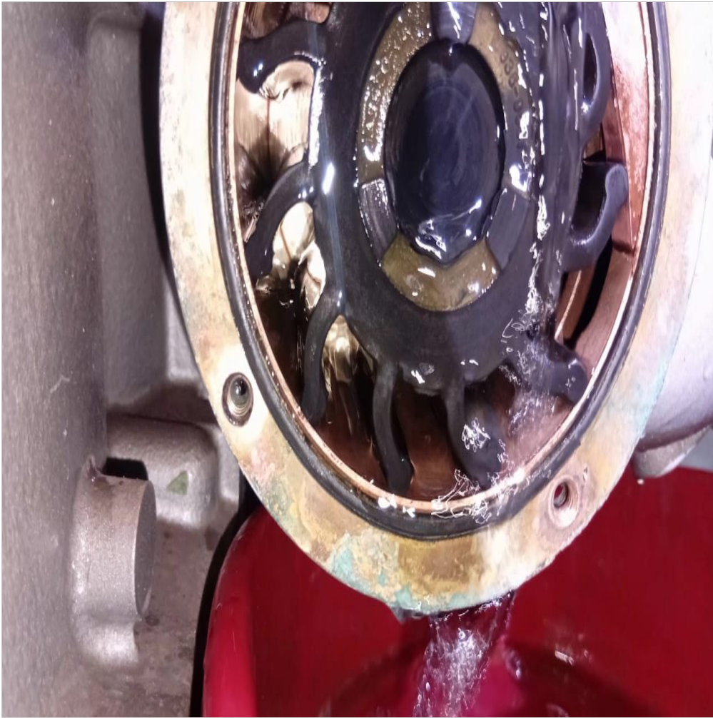
bomba de agua de mar
