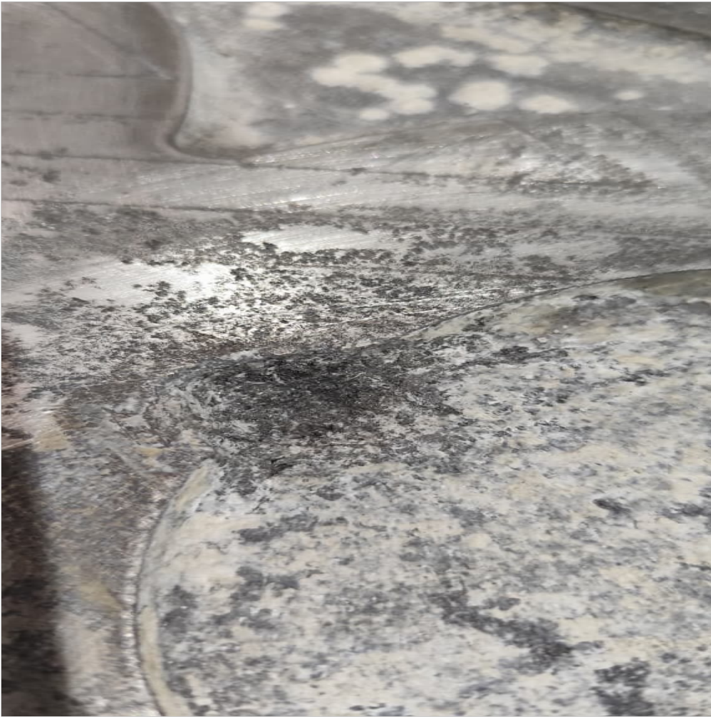
tapa frontal de enfriador de placas dañado
