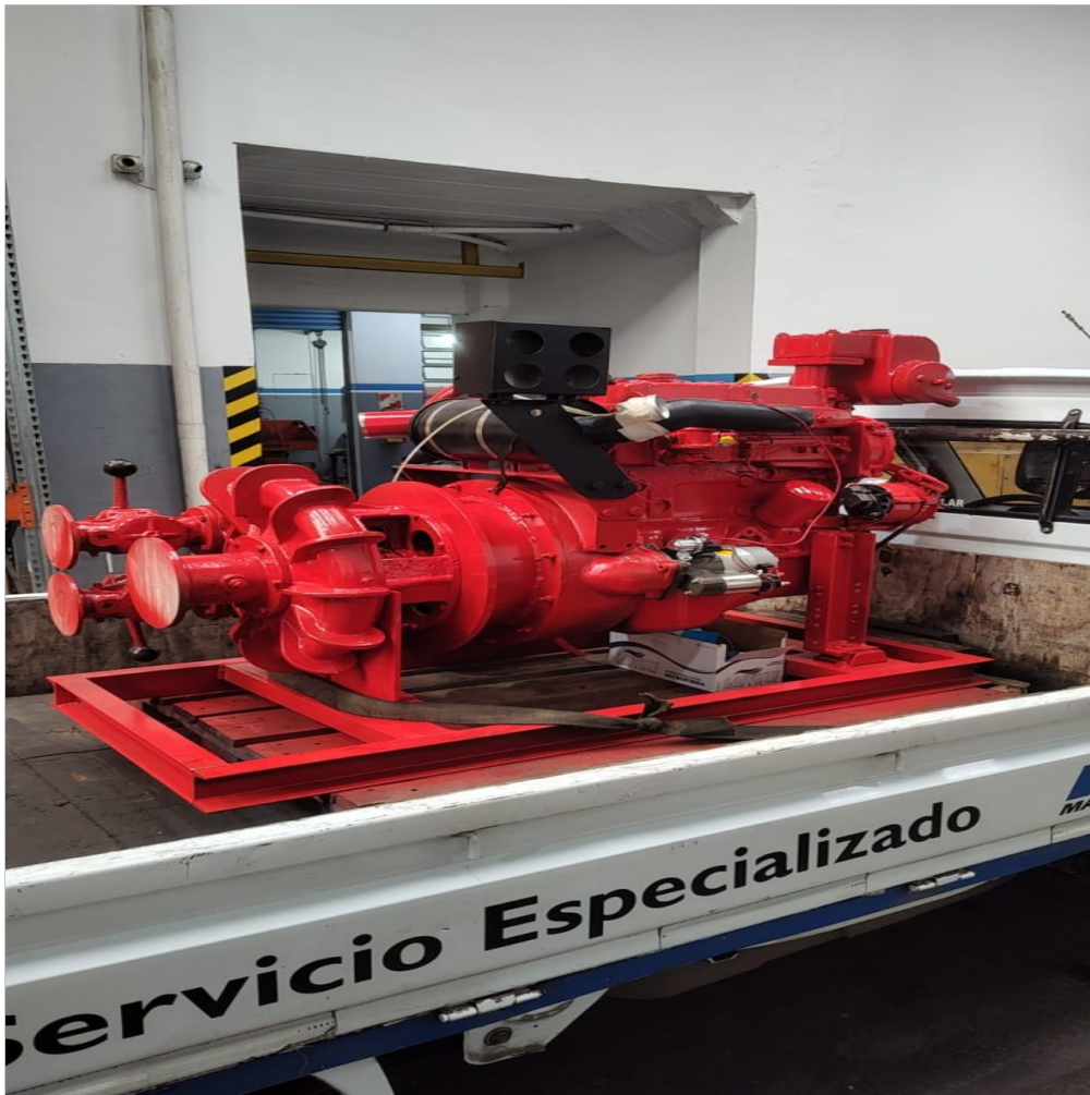
Bomba anti incendio y motor acoplados montados en el trineo
